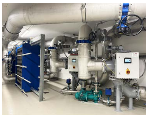
Blick in die neue Seewasserzentrale, die seit Mitte Dezember produktiv ist.
