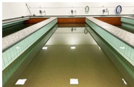
In den Vorfilterbecken findet eine erste Filtration des Rohwassers statt.
