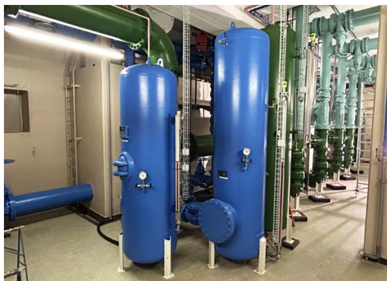
Im Vordergrund die Druckwindkessel, dahinter (grün) die Reinwasserpumpen.
