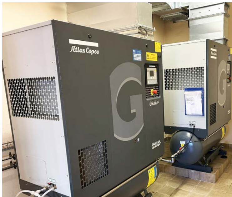
Die Luftkompressoren dienen der Ozonherstellung.
