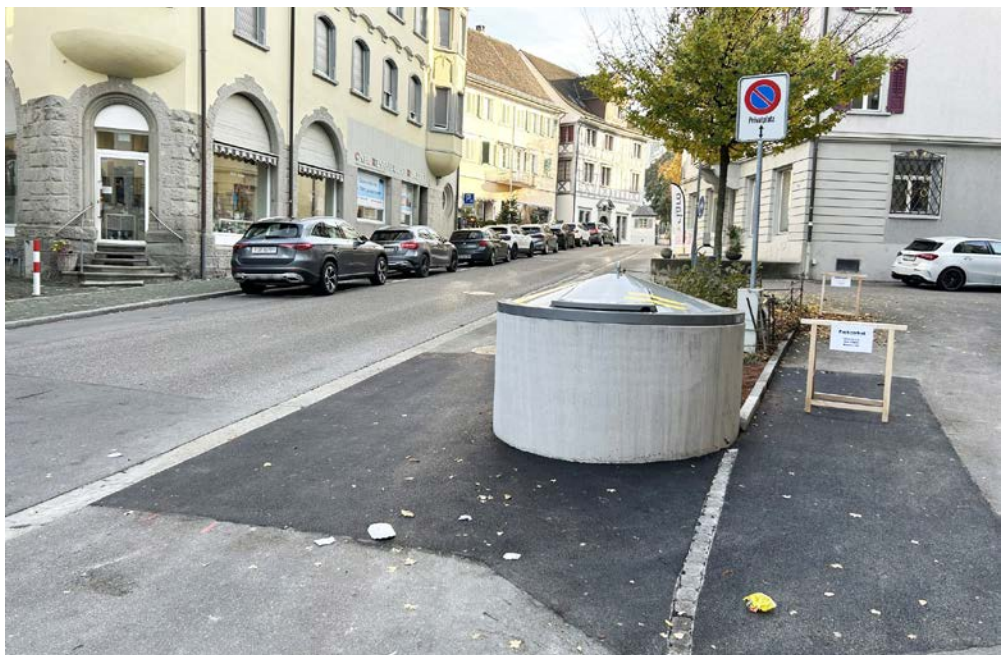
An der Marienbergstrasse steht seit kurzem ein neuer Unterflurbehälter. Ein weiterer ist in der Neugasse bei der Post platziert. Kein Grund mehr also, die Abfallsäcke an die Strasse zu stellen.
