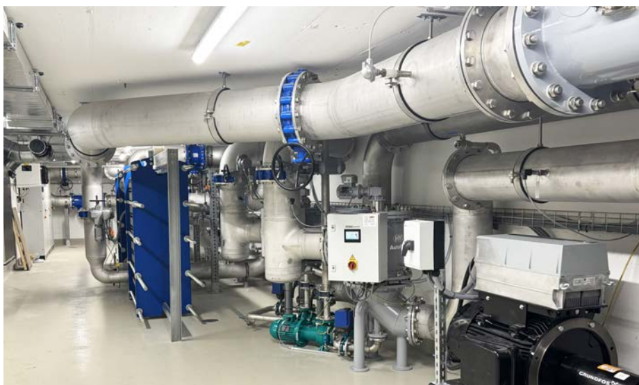
Blick in die neue Seewasserzentrale an der Hauptstrasse 30
